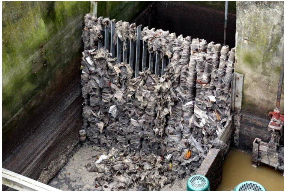
Dégrilleur dans un déversoir d'orage, colmaté par les lingettes © Philippe Riedinger
